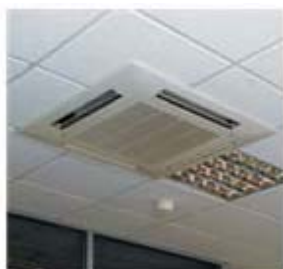
Ventilation et air conditionné
